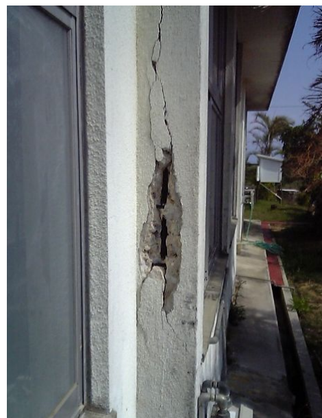
コンクリートの柱にひびの入った校舎
