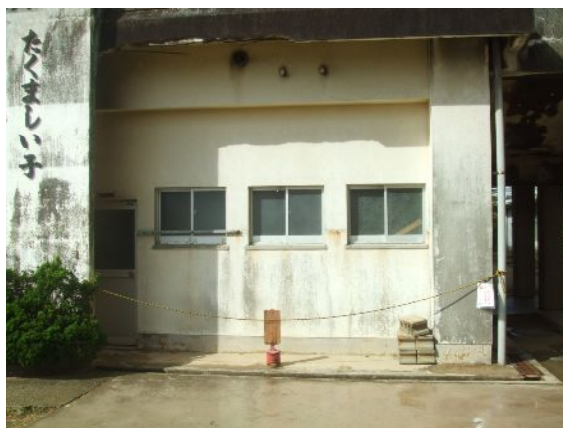
腐食のため立ち入り禁止のトイレ
